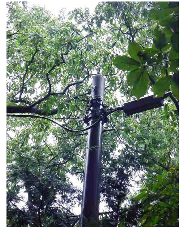
本線と接続する電信柱の上で、スズメバチが巣を
